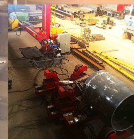
Автоматизированная сварочная система
